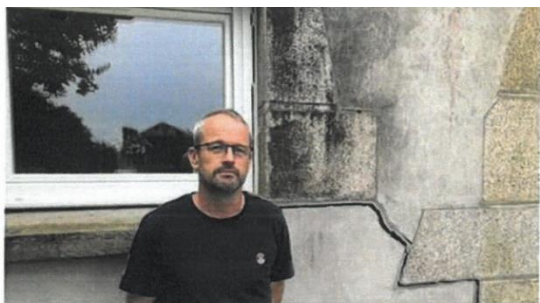
Jean-Vincent Aballea, devant la façade fissurée de sa maison à Plounévez-Lochrist (Finistère). | OUEST FRANCE
