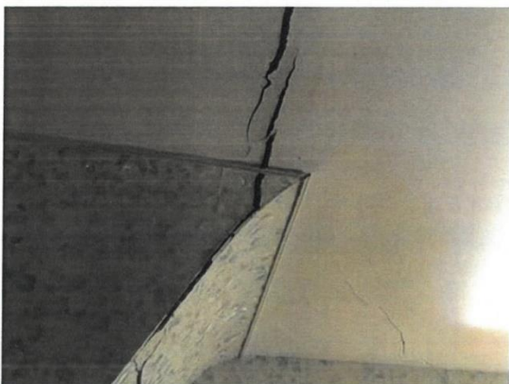
Des fissures impressionnantes sont apparues sur les murs de la maison du couple Aballea à Plounévez-Lochrist (Finistère). Ici, dans une des chambres à l'étage. | OUEST FRANCE
